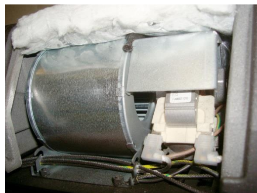
Figure n°29 - Accès aux fans
